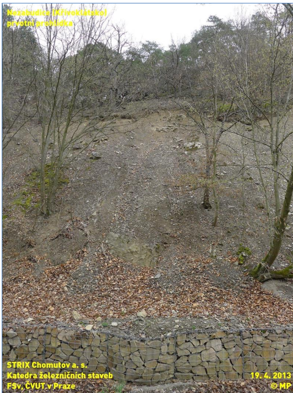
Obr. 9. Erozní rýha, suťové kuželíky a deformace záchytného prvku
