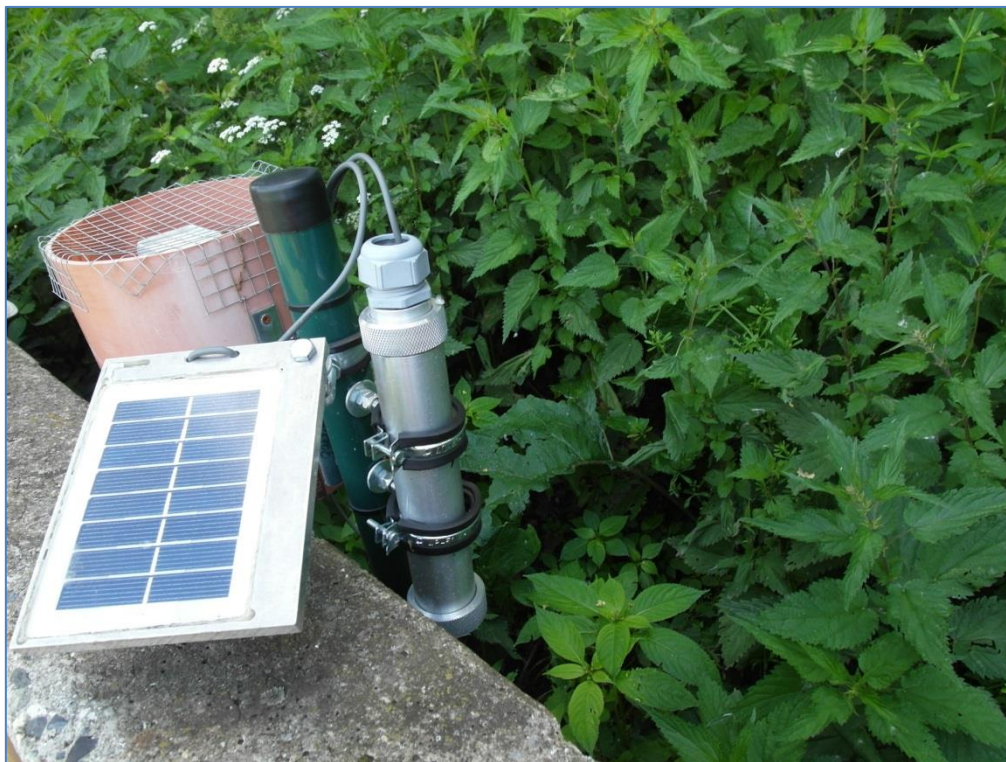
Obr. 64. Pohled na instalovaný člunkový srážkoměr STRIX
