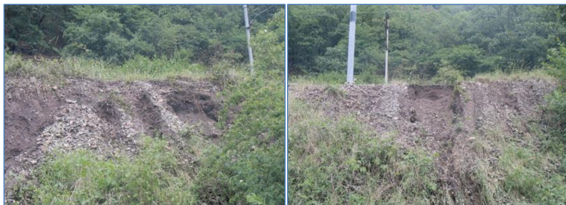
Obr. 14. Podemletí a následný dílčí sesuv náspu trati
