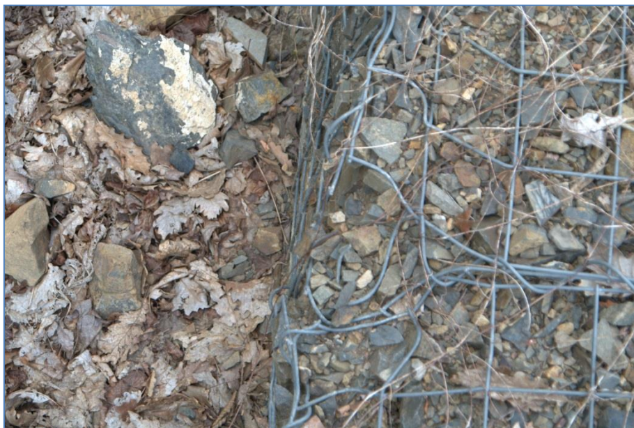
Obr. 1. Gabiónová konstrukce, zaplněná a poškozená působením zemitokamenitým proudem, Lokalita Zbraslav.
