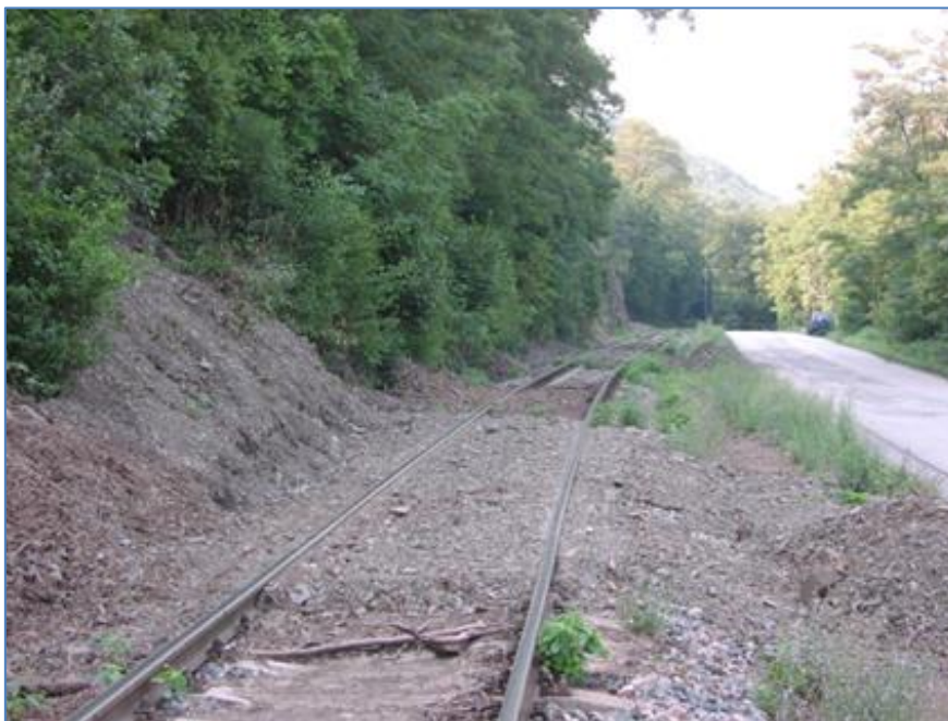
Obr. 36. Zanesení kolejového lože v důsledku svahových pohybů
